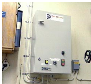
Styrskåpet med Telfas frekvensstyrning. Vi har lång erfarenhet av denna typ av pumpstyrning.
