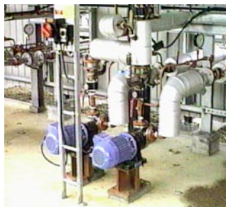
De tvillingmonterade turbinpumparna med sina explosionskyddade elmotorer.
